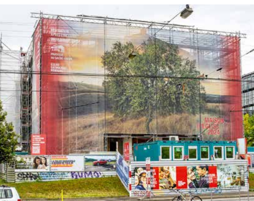
La reconstruction de l'église du Sacré-Cœur est en cours au centre de Genève.
